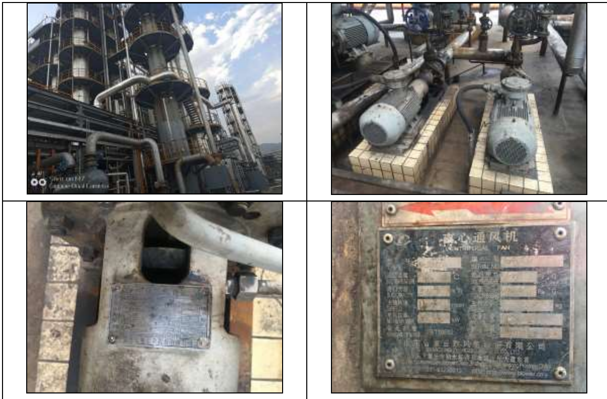
焦油尾气吸收塔及配套设施
