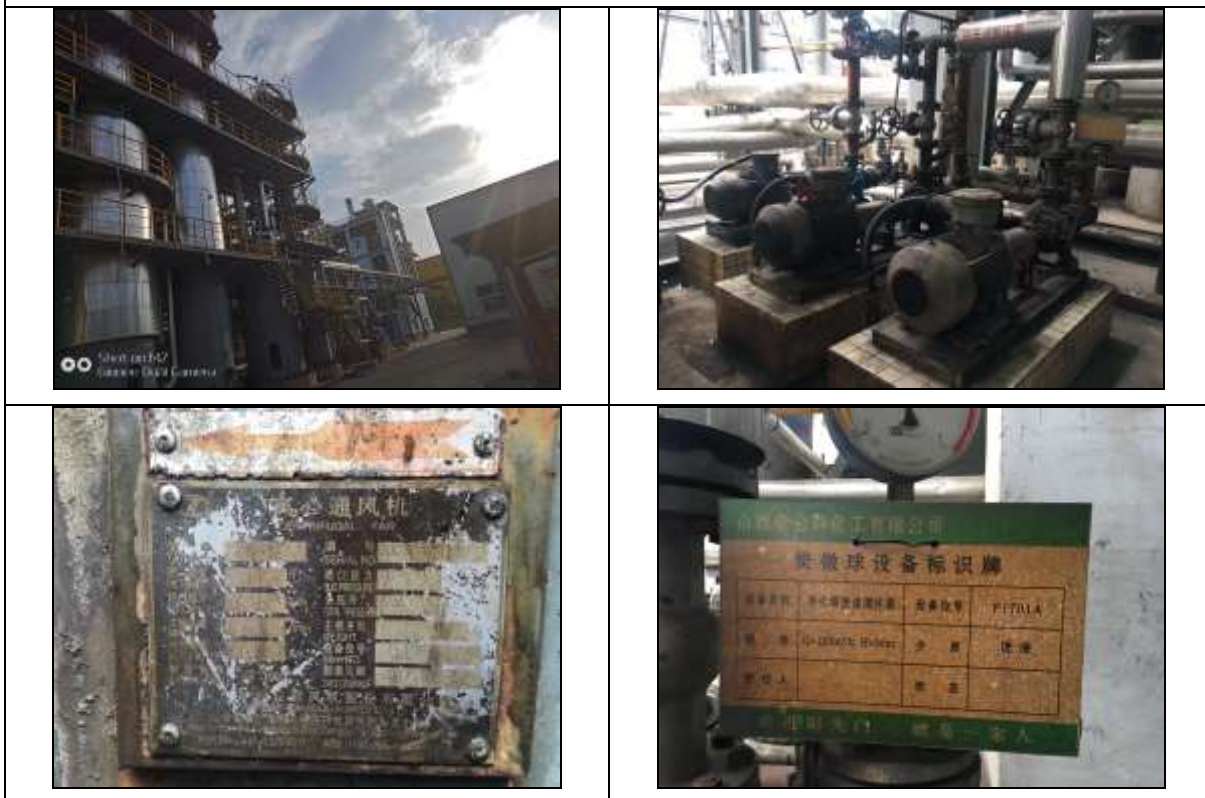
沥青尾气吸收塔及配套设施
