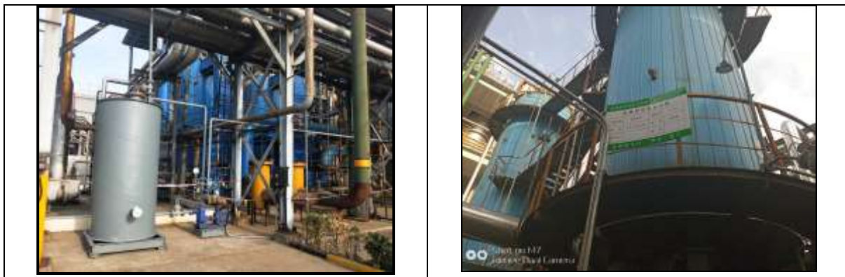
尿素液储罐及脱硝管道
